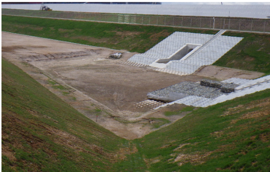
（参考写真）雨水調整池
